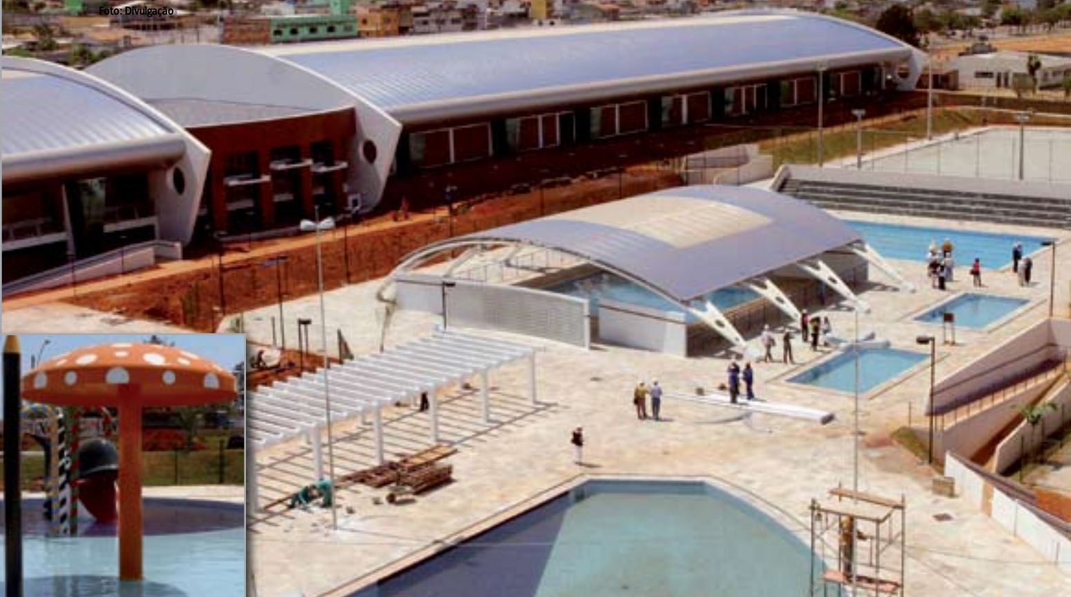
Operários capricham nos detalhes finais do Parque Aquático e dos jardins da nova unidade
